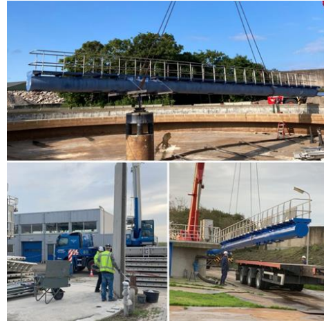
Voorbezinktank en slibbuffertank rwzi Den Helder
